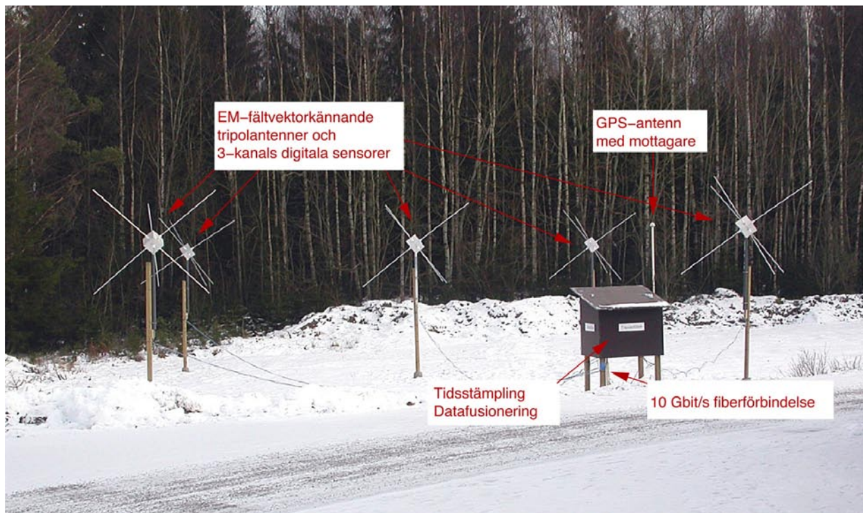
Fig. 2.5.2 LOIS teststation, Risinge, Växjö. LOIS (LOFAR Outrigger In Scandinavia) skall samverka med det stora europeiska sensornätverket LOFAR (Low Frequency Array) för rymd- och markstudier.
